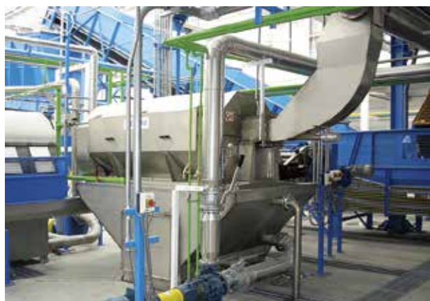
Filtragem de água Filtración agua
