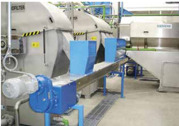
Filtragem mecânica Filtración mecánica
